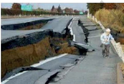
Obrázek 3: Sesuv násypu a porušení vozovky [1]
