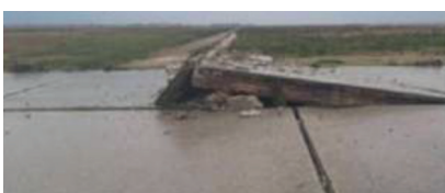
Obrázek 6: Lokální porušení betonové vozovky [1]
