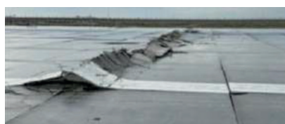
Obrázek 7: Rozsáhlé porušení betonové vozovky [1]
