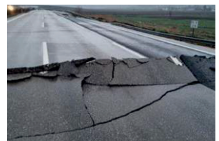
Obrázek 5: Příčná trhlina a pokles asfaltové vozovky [1]
